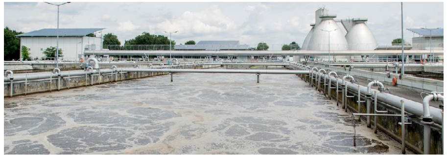
Belebungsbecken mit aktiver Belüftungsanlage
