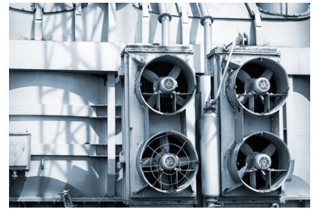
Vier Einzelventilatoren zur Effizienzsteigerung
