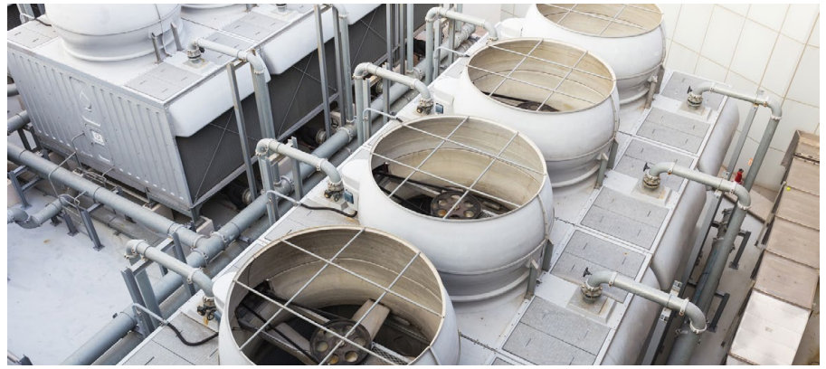
Freikühler im Außenbereich
