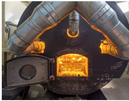
Holzverbrennung im Biomassekessel zur Wärmenutzung
