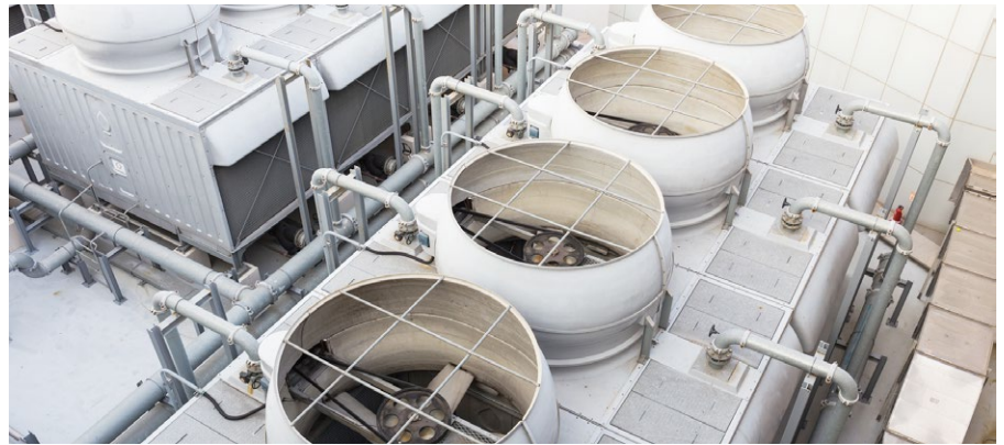
Freikühler im Außenbereich
